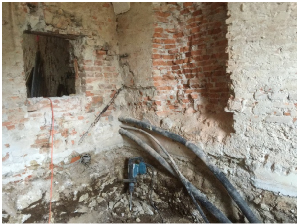
Alle möglichen Rohre treten hervor. Zuleitung Ortswasser und Brunnen.
