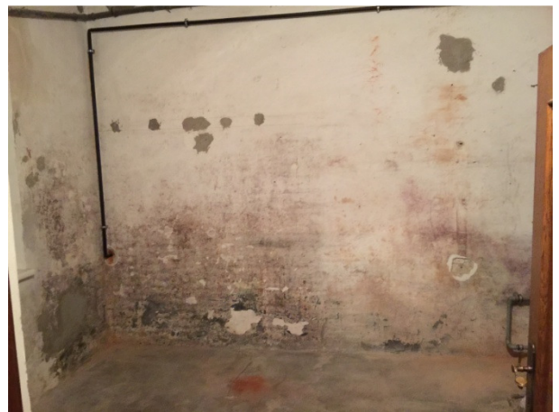
So war es einmal....(feuchte Mauern)
